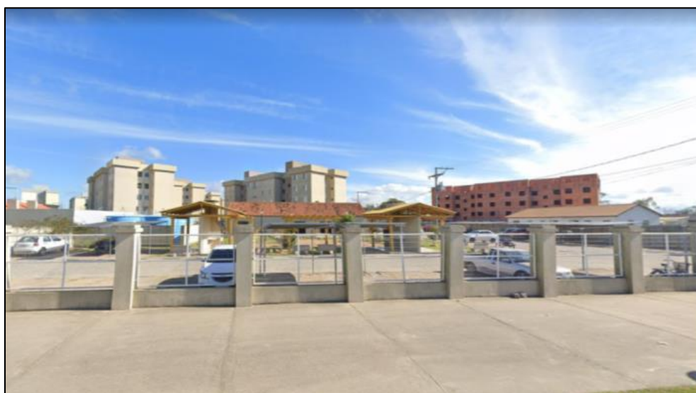
Figura 4 - Fotografia dos empreendimentos residenciais Jóquei Clube I, II e III finalizados, e o Solar da Lagoa ainda em construção
