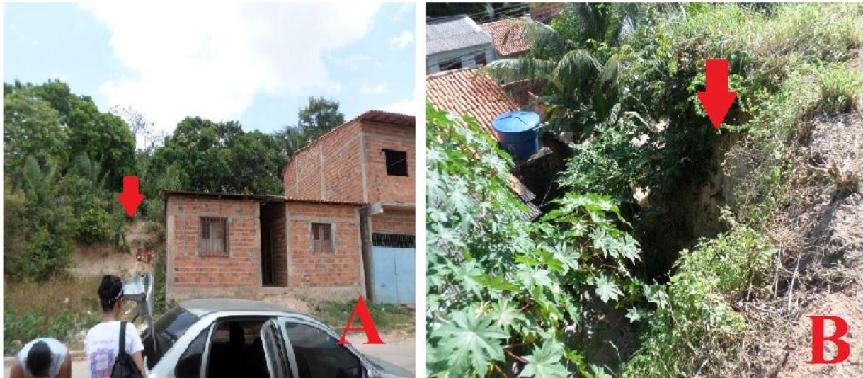
Figura 03: Escorregamentos no bairro Vila Embratel; A – Cicatriz de escorregamento rotacional na vertente localizada na Rua 15; B – Escorregamento translacional na Rua Santa Tereza
