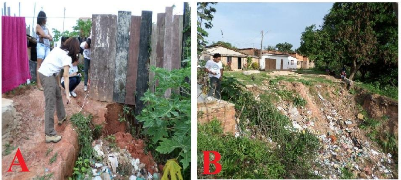
Figura 02: Escorregamentos rotacionais no bairro Salinas do Sacavém; A – Medição do terreno onde ocorre o escorregamento; B – Ocorrência de rastejos na vertente com presença excessiva de resíduos sólidos
