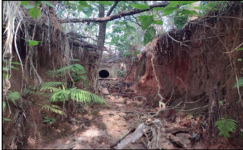
Figura 07 – Ravina na área 2 do Parque Municipal Natural Lagoa das Garças em Juína/MT
